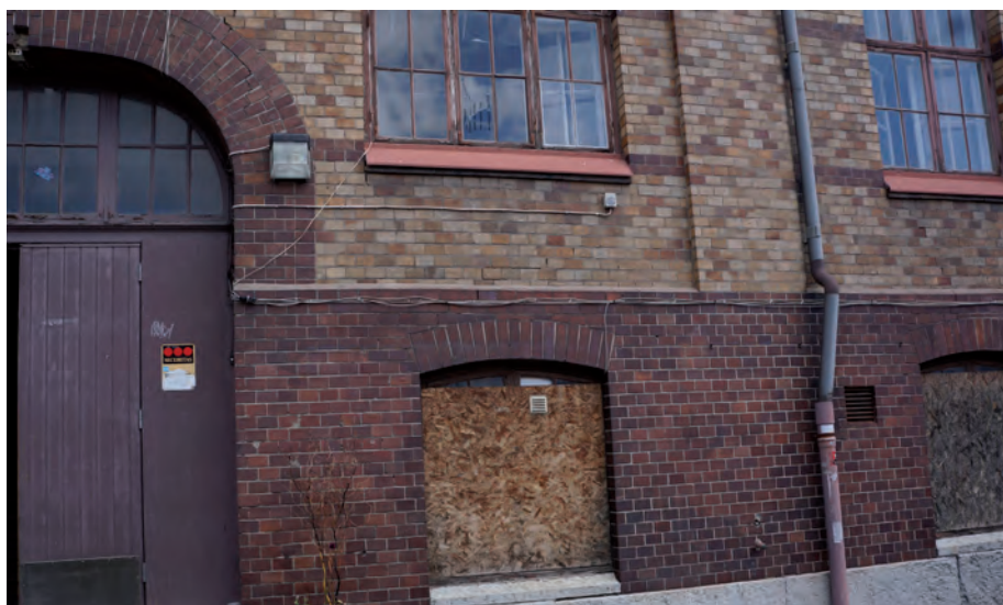
Zewnętrzny wygląd budynku świadczy o zaniedbaniu. Okien nie naprawiano lecz po prostu zabijano dyktą.
